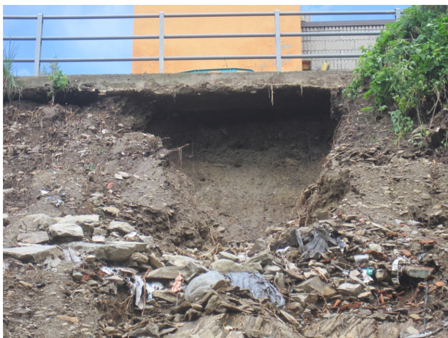
Particolari, da valle e laterale, dello scavernamento sottostante la sede stradale di Via Mulini.
