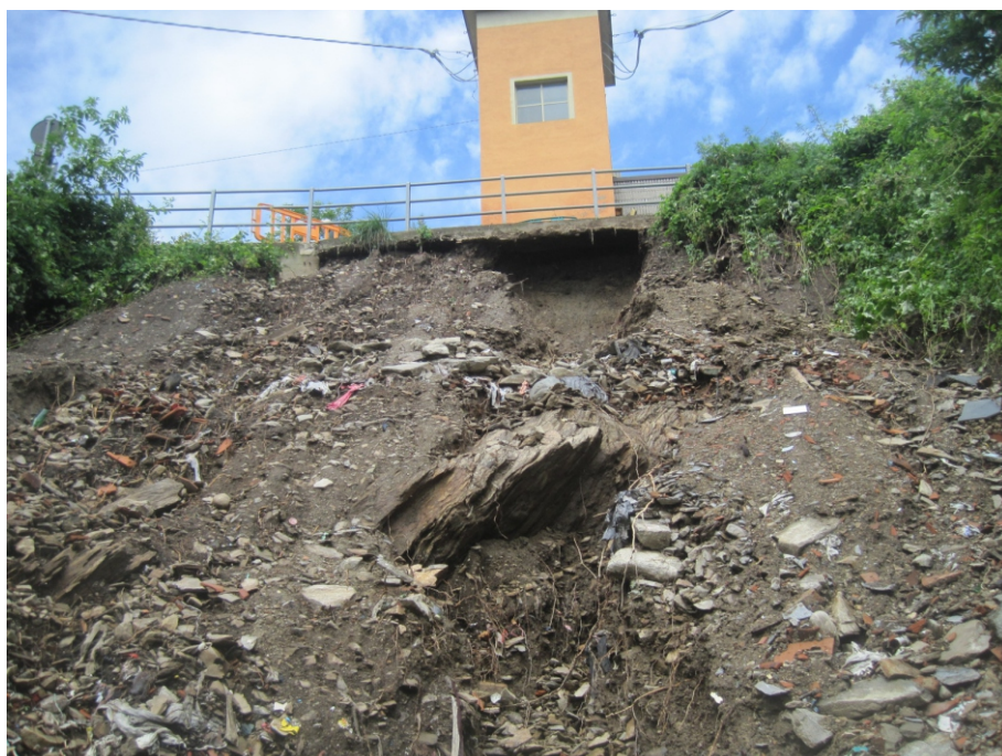
Veduta da Via degli Alpini dell'area di frana; lungo il canalone centrale, si apprezza l'affioramento roccioso, messo a nudo dallo scivolamento gravitativo.
